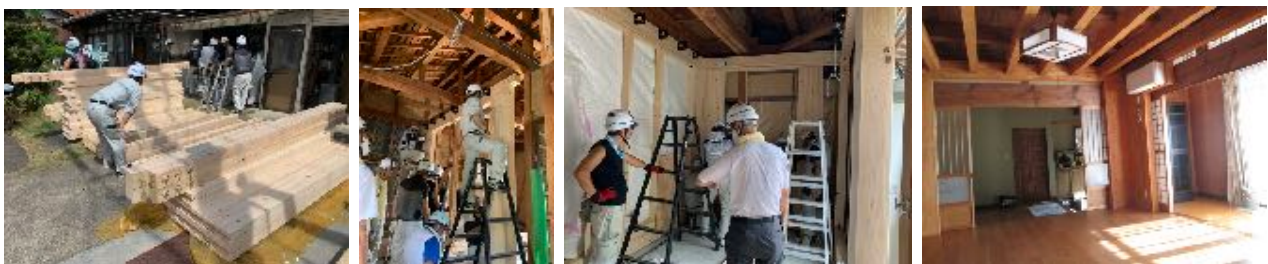
岐阜県T邸 (2019年12月設置)
